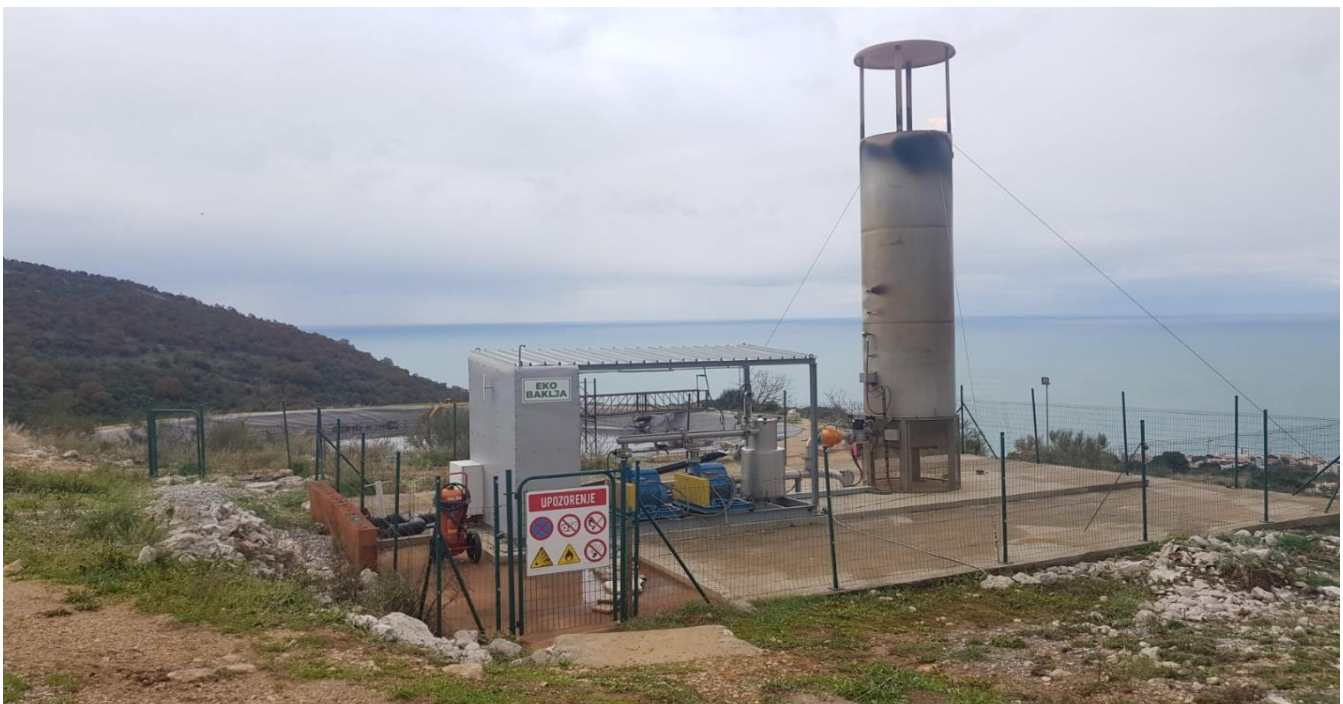
Foto 3: Impianti për djegjen e gazit të deponisë në Deponinë Mozhura
