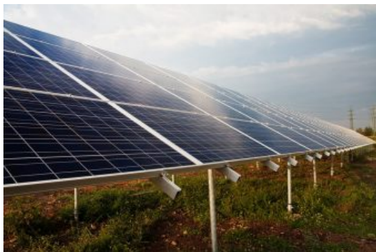
Slika br. 13. Solarna elektrana instalirana na zemlji
