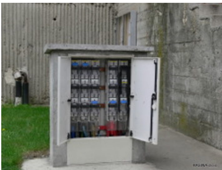
Sl. Izgled niskonaponskog razvodnog ormana sa 6 izvoda »NKRO6«
